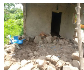
Photo 4 : maison détruite par les pluies diluviennes dans la commune de Sotouboua I (Tabindé Pouda) le 30/08/2026
