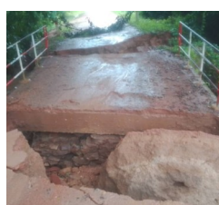
Photo 1 : Destruction du pont à Was-sarabou le 17/08/2026 (Tchaoudjo)
