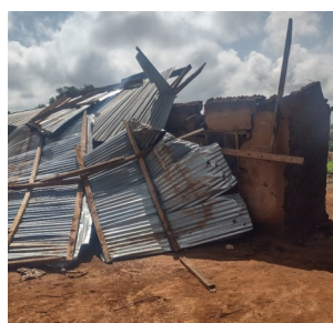
Photo 3 : dégât de vents violents dans la commune de Bitta 3 (Katchenké) le 09/06/2026
