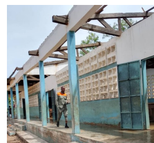
Photo 3 : cas de bâtiment scolaire décoiffé suite aux vents violents dans la préfecture d'Amou (EPP Bato) le 17/05/2026
