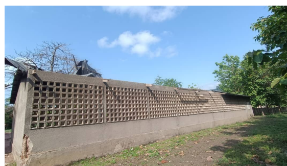
Photo 1 : dégât de vent violent à EPP DUGBA ( kpelé 1) 17 /03/2026
